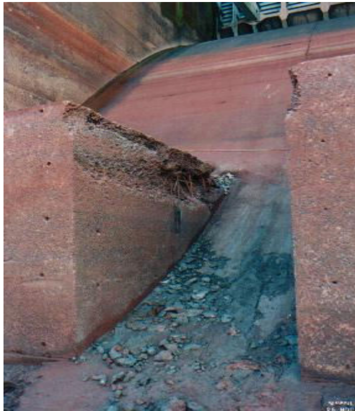
Figura 3.1 – Erosão causada pelo processo de cavitação na estrutura de dissipação de Porto Colômbia.
