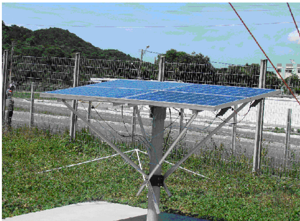
Figura 38 – Painel instalado no LABDTE Fonte: Fotografia do autor
