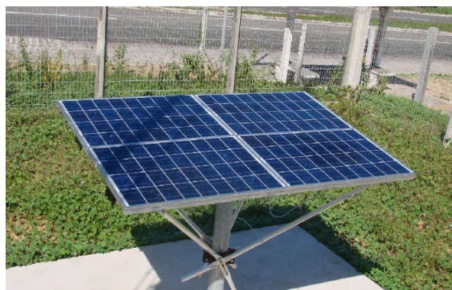
Figura 44 – Módulos fotovoltaicos com sombreamento momentâneo.
