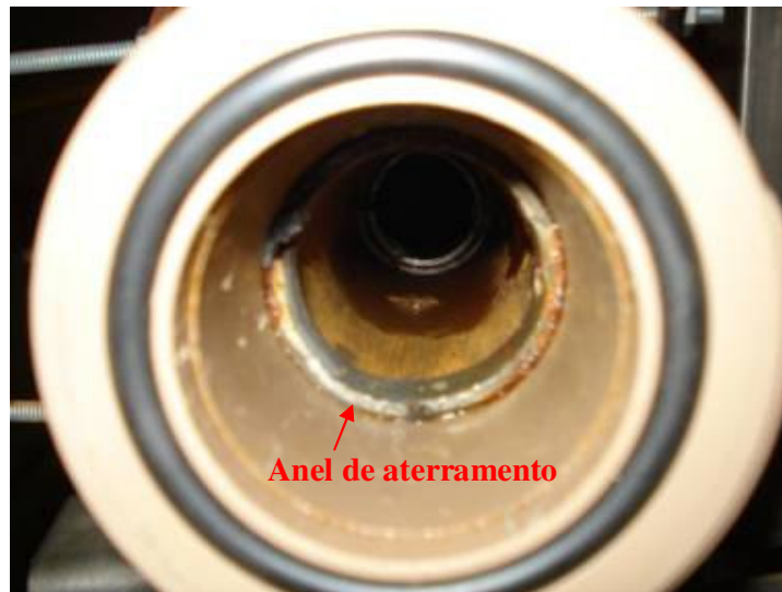
Figura 34 – Detalhe de anel de aterramento
