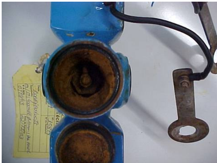
Figura 6 – Medidor eletromagnético com defeito devido a especificação incorreta (corrosão dos eletrodos)
