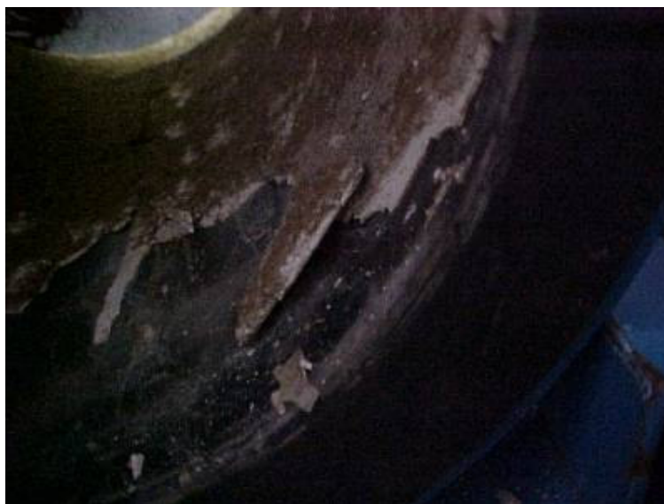
Figura 5 – Medidor eletromagnético com defeito devido a instalação incorreta (corrosão do material de revestimento interno do tubo)
