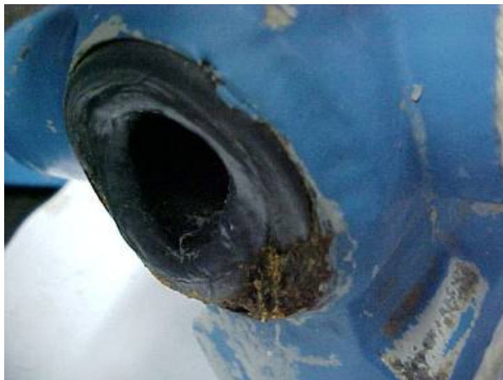
Figura 4 – Medidor eletromagnético com defeito devido a instalação incorreta
