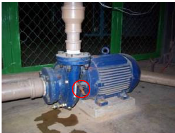
Figura 40 – Orifício para inserção de bolhas na tubulação (destaque)
