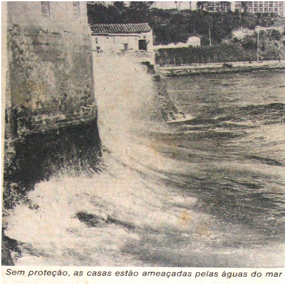
Foto A1.7 - JORNAL A TARDE 07/04/81: -CASAS DO RIO VERMELHO SÃO INVADIDAS PELO MAR: A alta maré, que acaba invadindo cozinhas, varandas e copas de residências, além de estragar as paredes, portas e objetos de utilidade doméstica. Na tarde de ontem, enquanto as fortes ondas invadiam casas, as águas ultrapassavam a balaustrada que contorna o mar, no trecho do calçadão – que fica defronte aos fundos do Cine Rio Vermelho, onde está localizada uma loja de artesanato do Sesi-FIEB.
