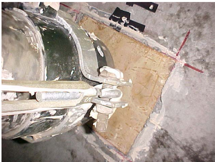
Figura G.14 – Superfície de ruptura da laje
