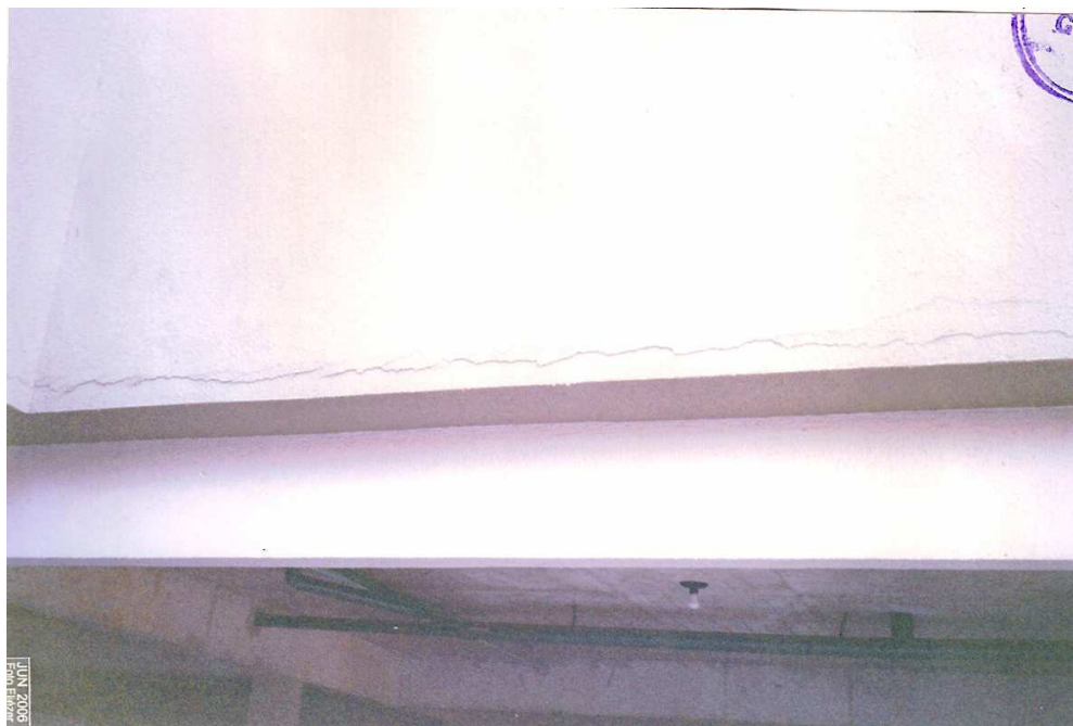
Figura 3.27 - Fissura horizontal na alvenaria devido à deformação da laje em balanço.
