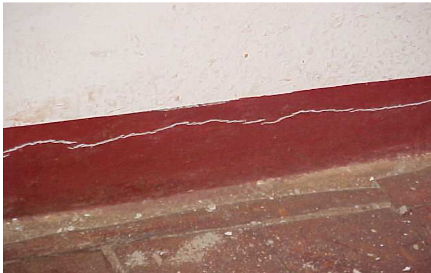
Figura 3.25 - Trinca horizontal na base da alvenaria por efeito da umidade do solo.
