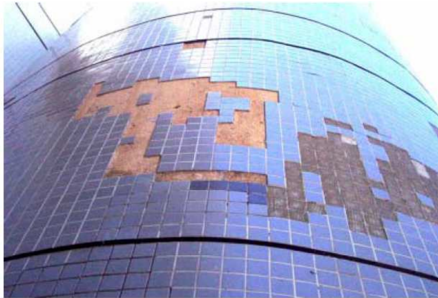
Figuras 3.42 – Destacamento do revestimento cerâmico da fachada (COMUNIDADE DA CONSTRUÇÃO, 2004).
