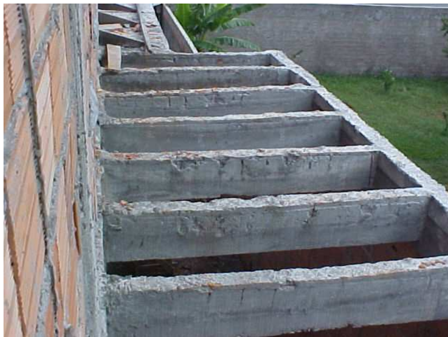
Figura 3.18 - Vigas em concreto armado com deficiência de qualidade e espessura de cobrimento.
