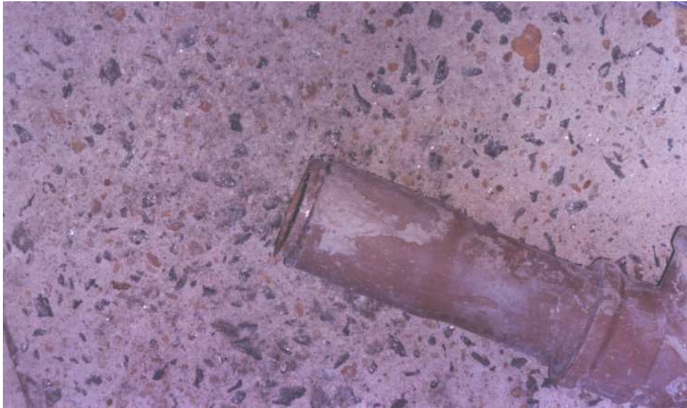
Figura 3.43- Trechos de tubulações unidas a fogo sem utilização de conexões.
