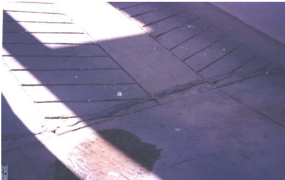
Figura 3.49 – Trinca na proteção mecânica executada sobre o sistema de impermeabilização.
