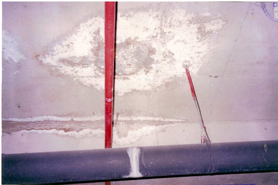
Figura 3.17 - Vista de uma laje térrea com eflorescência devido ao processo de lixiviação, devido à falha na impermeabilização.
