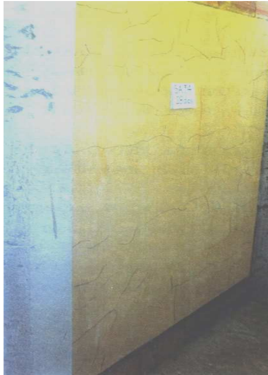
Figura 3.39 – Fissuras mapeadas devido à retração da argamassa pela utilização de 34% de finos argilosos, saibro (ANGELIM, 2000).
