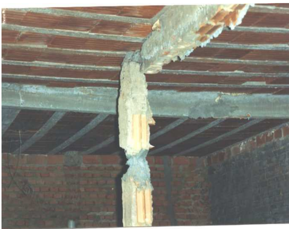
Figura 1.01 – Irregularidade geométrica nas seções de pilar e vigas de concreto armado, obra destinada à residência, executada em Goiânia/1994.
