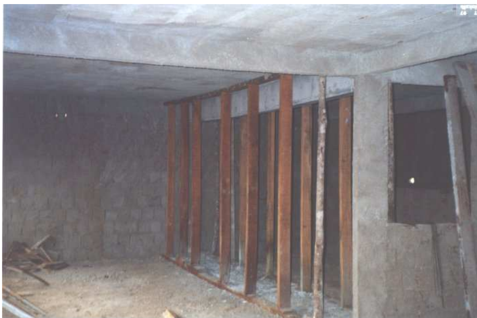
Figura 3.13– Estrutura em concreto armado escorada devido à deformação estrutural.
