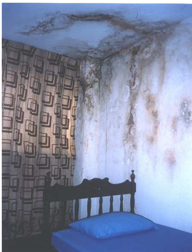
Figuras 3.41 – Manchas de umidade no revestimento com predominância de bolor.
