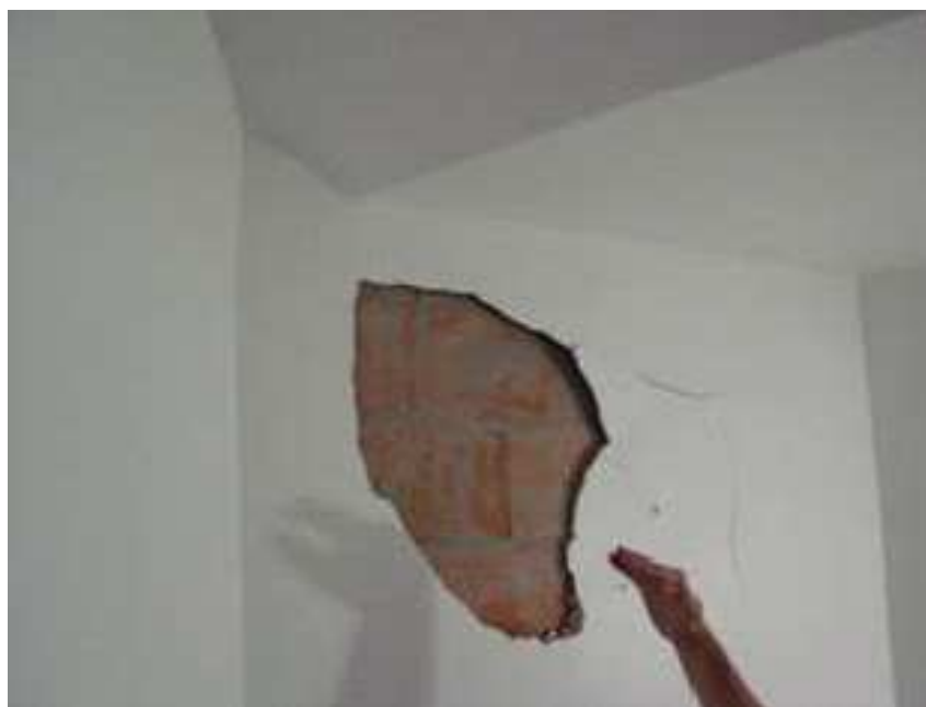
Figura 3.35 – Descolamento da argamassa de revestimento (ABCP, 2006).
