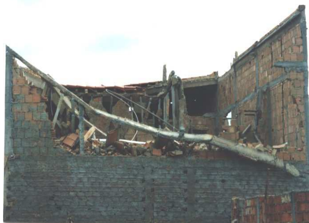
Figura 1.02 – Desabamento parcial de um sobrado de concreto armado, obra destinada à residência, executada em Goiânia/1994.
