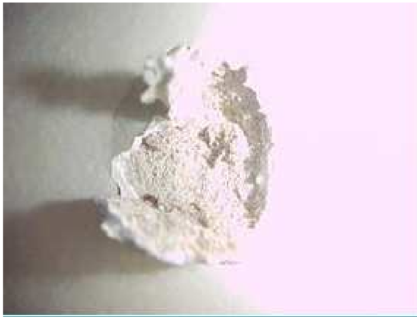
Figura 3.36 – Vesículas na argamassa de revestimento (ABCP, 2006).
