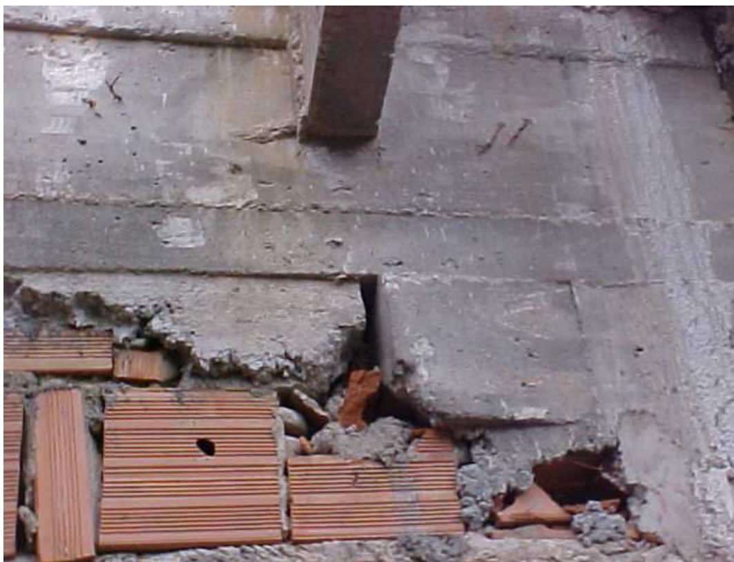
Figura 3.19- Elementos em concreto armado com irregularidades geométricas.
