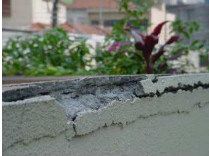
Figura 3.26– Fissura no topo da alvenaria de um peitoril devido ao efeito higroscópico (ABCP, 2006).
