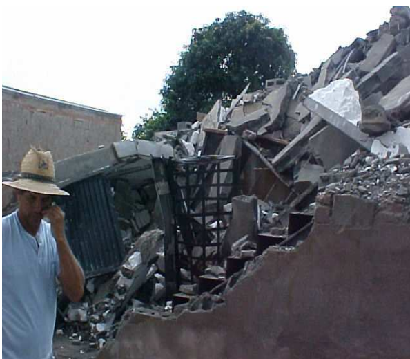
Figura 1.03 – Desabamento total de uma obra destinada à escola, executada em Goiânia/2004.
