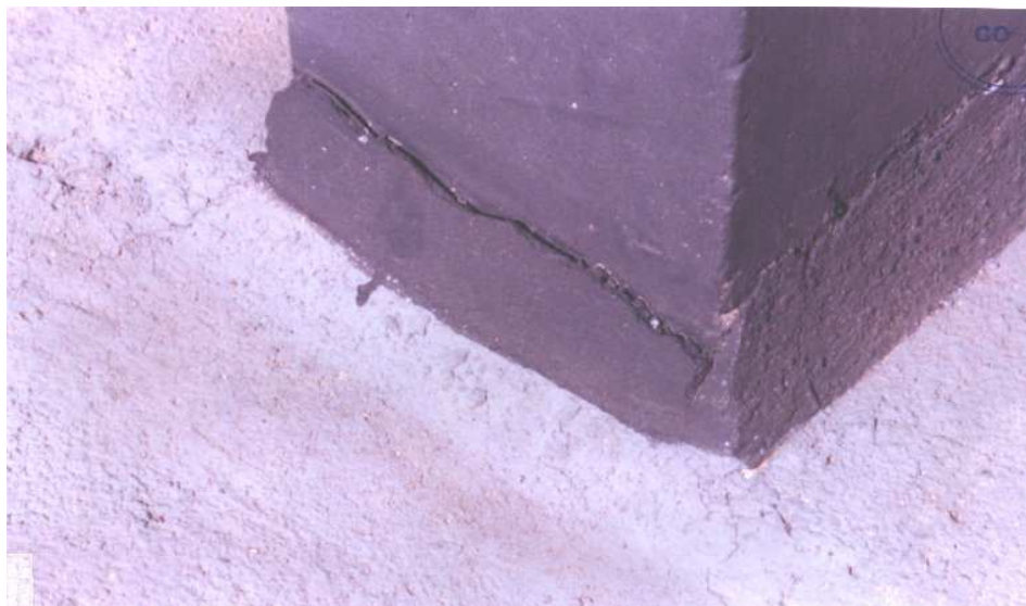
Figura 3.48 – Fissura entre o sistema de impermeabilização e o pilar.
