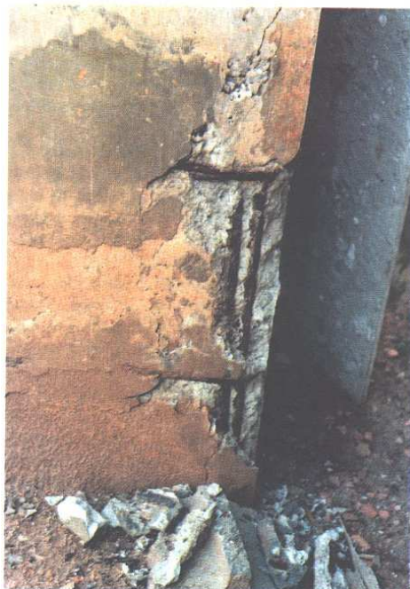
Figura 3.14 – Corrosão da armadura do pilar com destacamento do concreto do cobrimento (CASCUDO, 1997).
