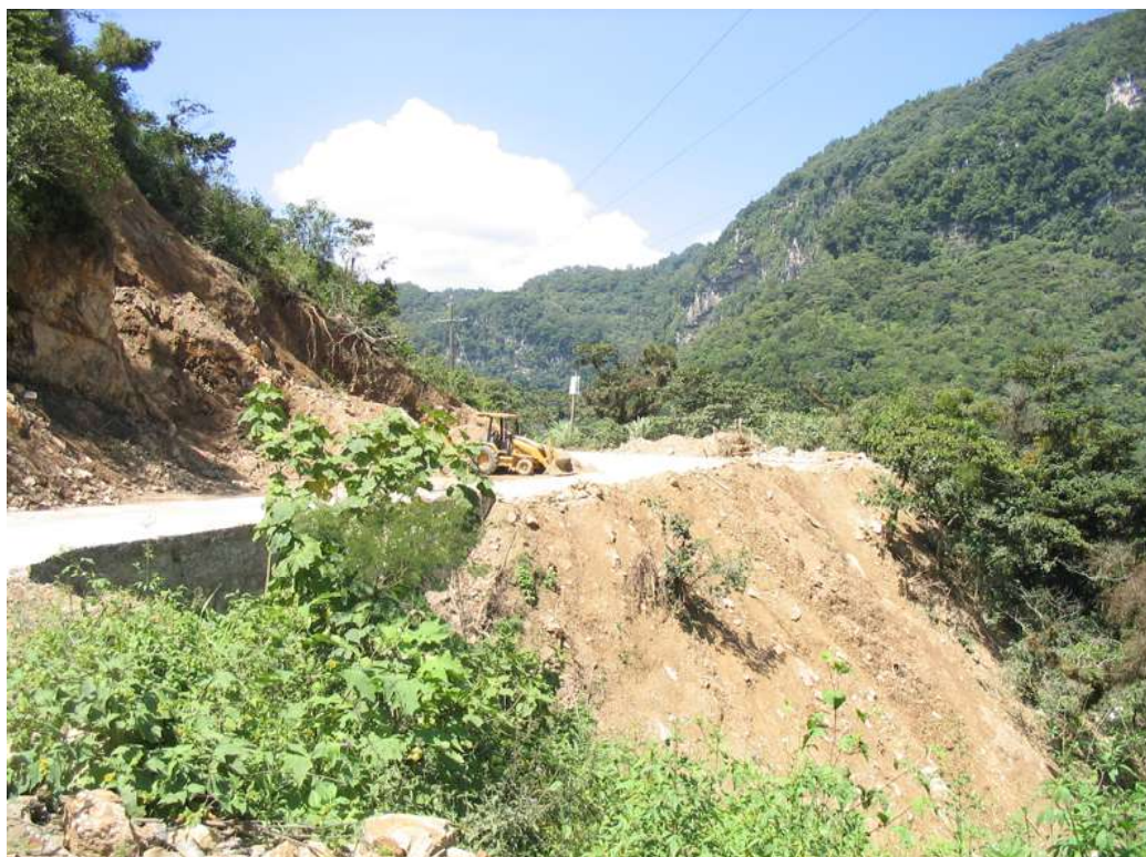
Figura 23. Queda de barreira na estrada para Chilchotla, na área média da Sierra. Foto do autor.
