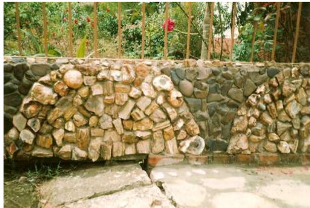
Figura 7 - Muro de uma casa em Mata (RS) (Fonte: Portfólio da autora, 2003)
