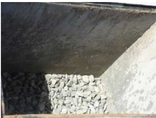
FIGURA 43 – Caixa de passagem com pedras.
