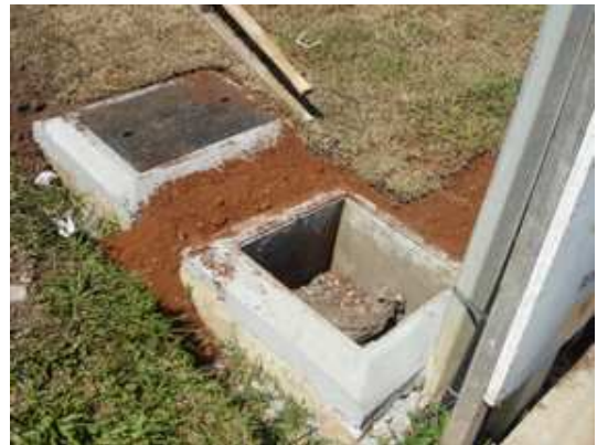
FIGURA 42 – Caixa de passagem para fiação.
