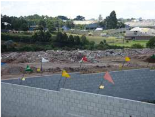
FIGURA 70 – Resíduo de construção disposto em terreno.
