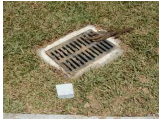
FIGURA 27 – Grelhas para retenção de resíduos.
