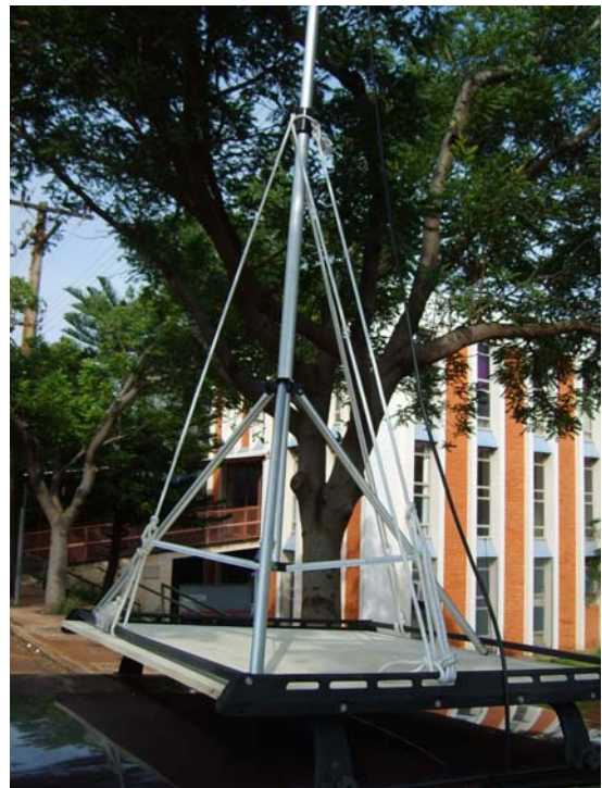
Figura 17 - Detalhe da estrutura de montagem da antena
