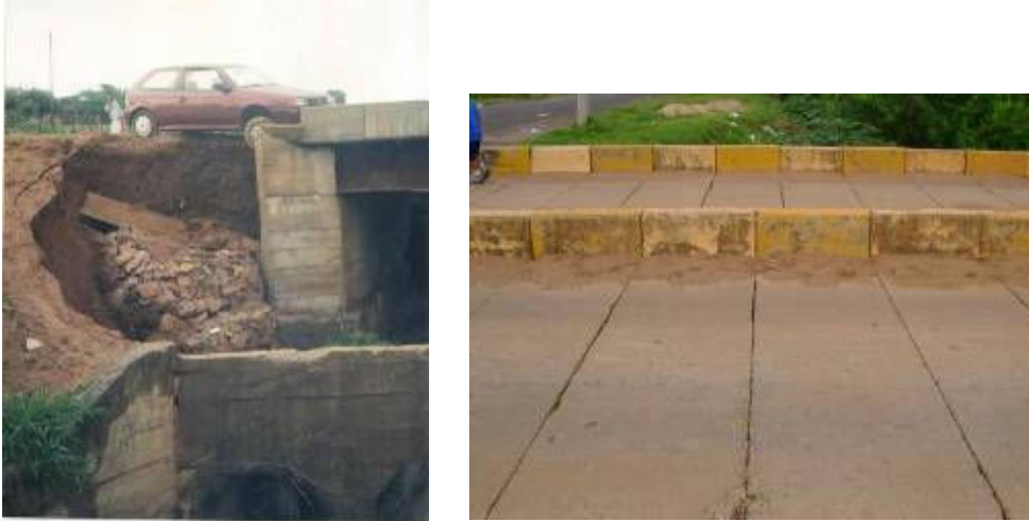
Fotos 30 e 31. À esquerda, carro de passeio preso entre rua não pavimentada e Ponte Tomara que Caiu. À direita, é possível observar o desalinhamento dos bloquetes de concreto de tal ponte. (Cedidas por Manoel, 2006)
