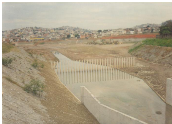
Figura 63a – Entrada do Córrego Guaraú com paliteiros para controle de resíduos sólidos.
