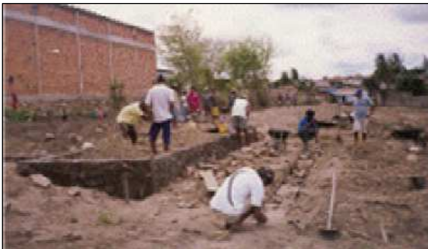
Imagem 12: O início das obras, organização do canteiro em dia de mutirão, julho de 2006.
