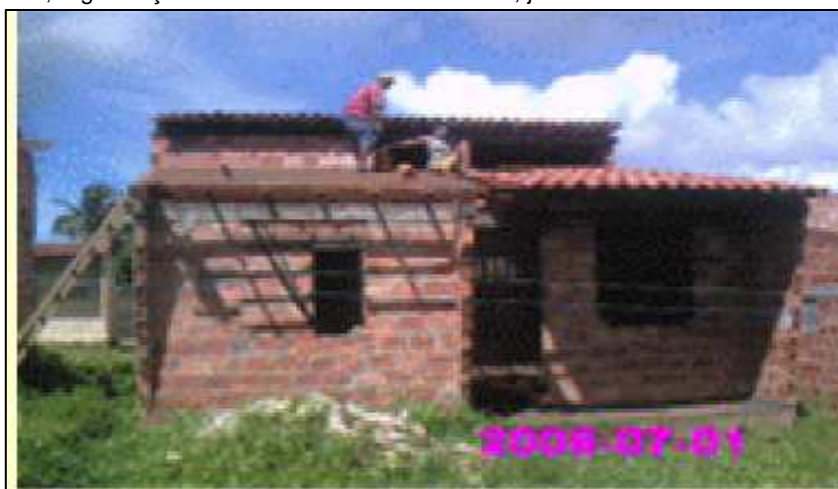
Imagem 13: Em fase final de construção. Pode-se observar uma preocupação com projeto, pelo desenho da fachada.
