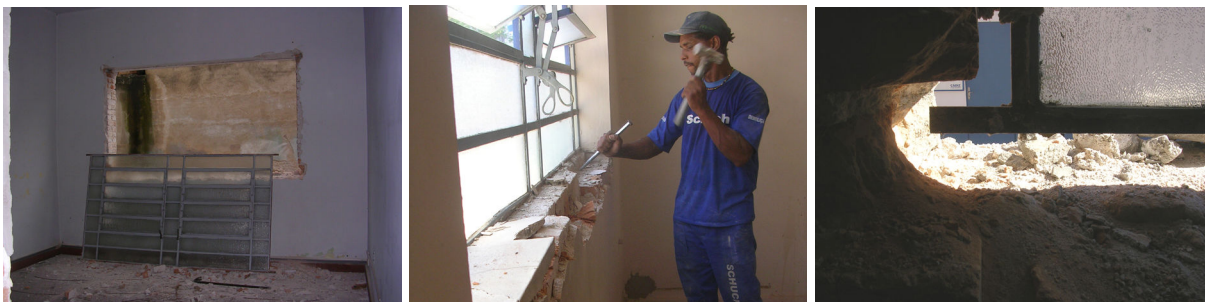
Figura 55: Esquadrias de ferro, fixadas com chumbadores em paredes espessas (Demolição A)
