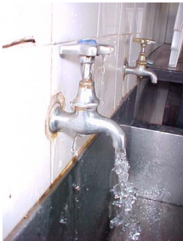
Torneira de lavatório tipo calha vazando no eixo quando aberta
