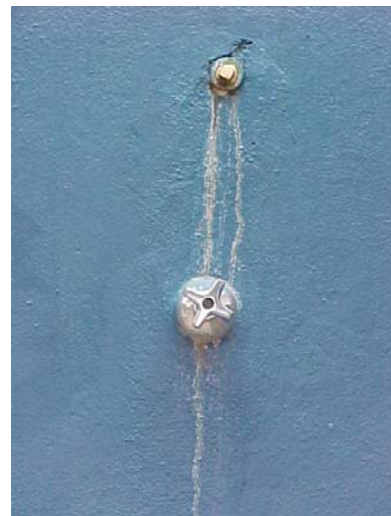
Registro do chuveiro com vazamento
