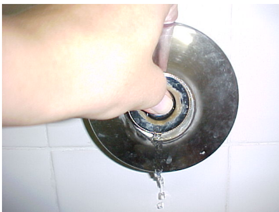
Vazamento em válvulas de descarga
