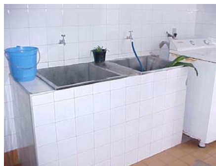
Torneira de tanque de lavar roupas e máquina de lavar roupas
