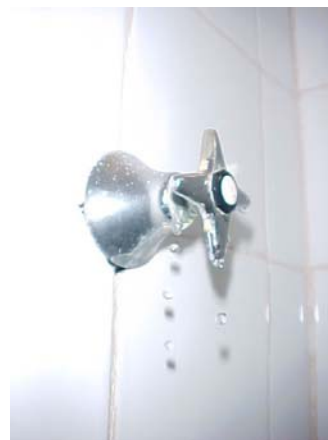
Registro de mictório com gotejamento lento
