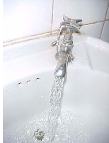
Torneira de lavatório com vazamento no eixo quando aberta
