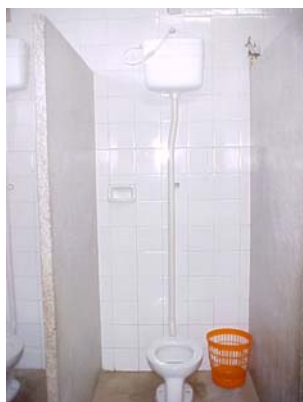
Bacia sanitária com caixa de descarga
