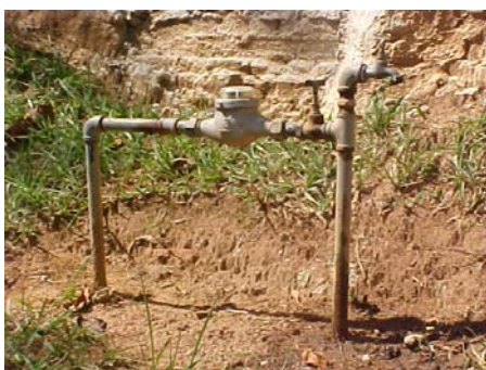
Torneira de uso geral externa
