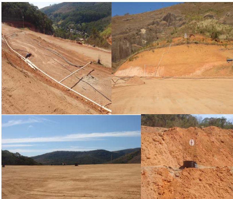
Foto 76: Sistema de drenagem de gases
