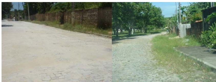
Foto 109: Terra nas ruas e sarjetas sujas / capim dificulta o escoamento das águas
