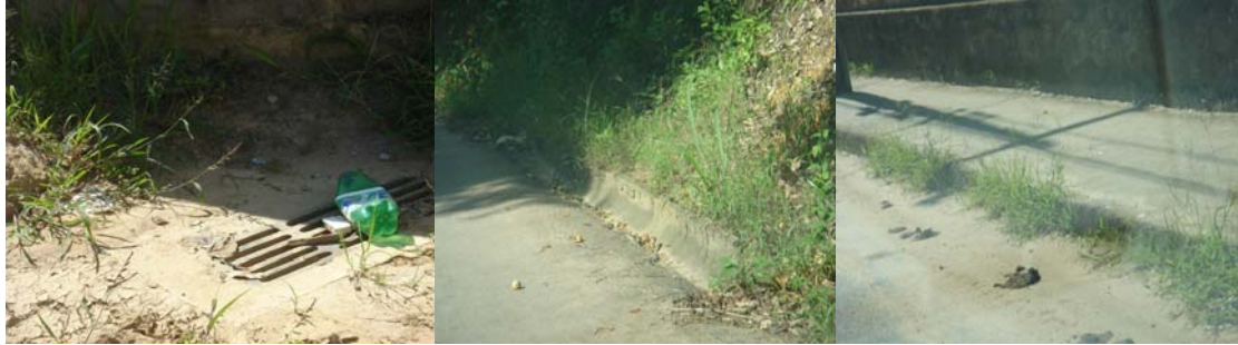
Foto 44: Deficiência de limpeza de sarjetas e bueiros /meio fio com capim e terra
