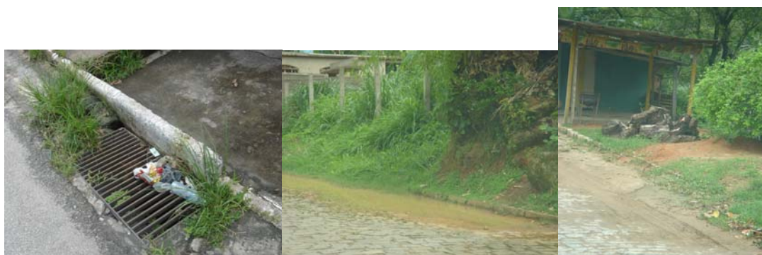
Foto 12: Capim e lixo acumulado nos bueiros e sarjetas dificultando escoamento das águas
