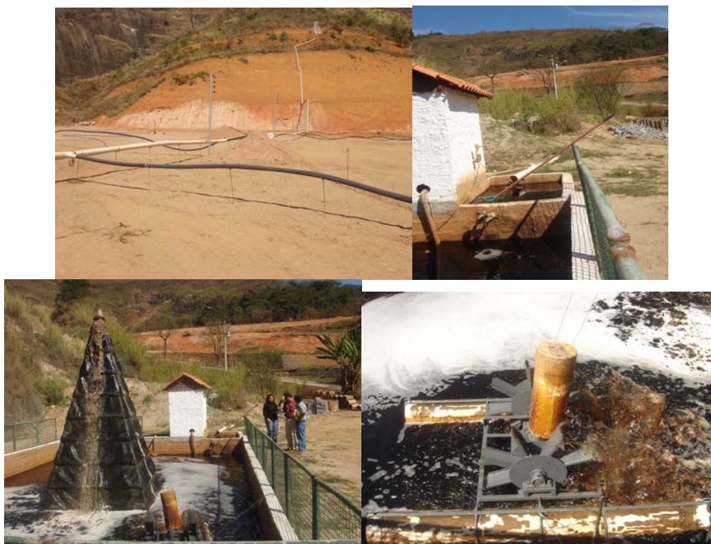
Foto 77: Sistema de tratamento de chorume do aterro
