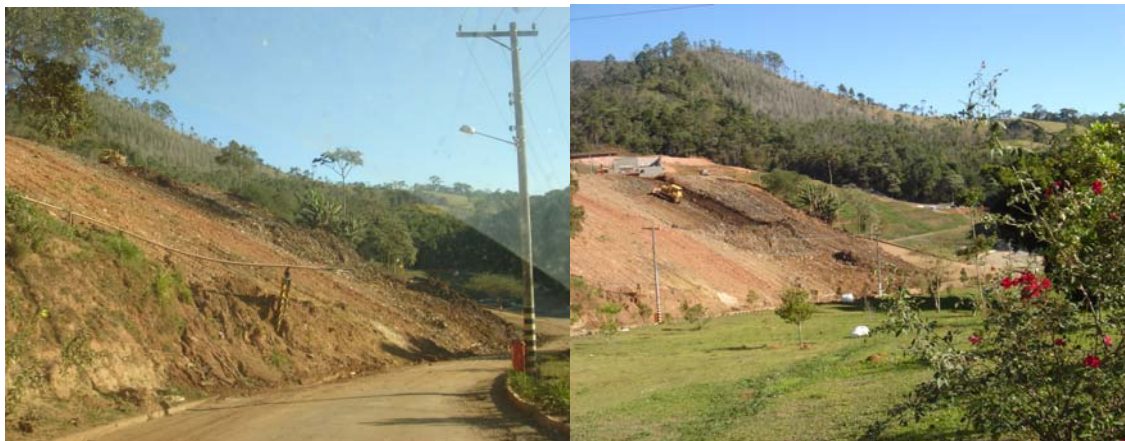
Foto 65: Escorregamento do talude em área encerrada
