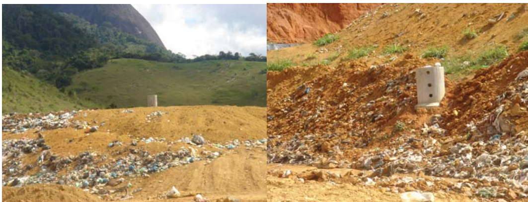
Foto 137: Drenagem de gases no aterro
