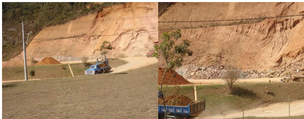
Foto 128: Escorregamento do talude do material para recobrimento/ RCC disposto no aterro
