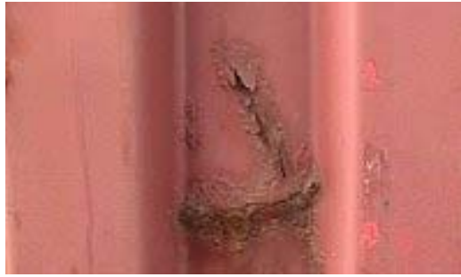
Figura 4.5 – Exemplo de oxidação na parede do container (www.containerhandbook.de; 2005)
