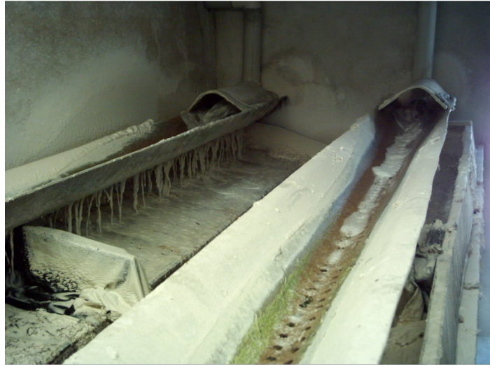
Figura 9 – Calha de lavagem.
