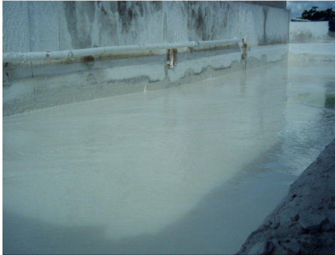
Figura 11 – Tanque de decantação II.
