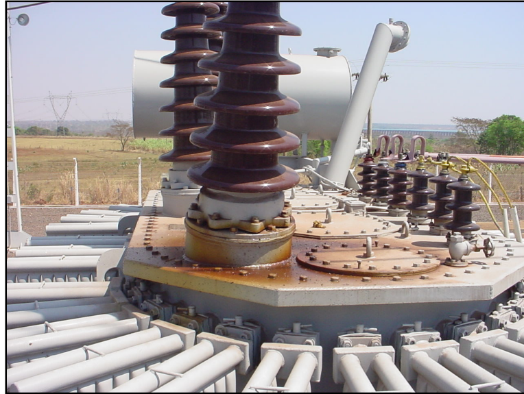
Figura 3.9 - Vazamento do óleo mineral pelo tanque do transformador.
