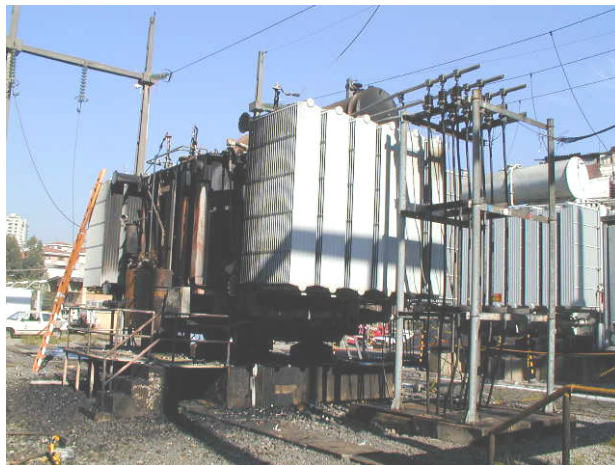
Figura 2.2 – Transformador de potência em uma subestação de energia.
