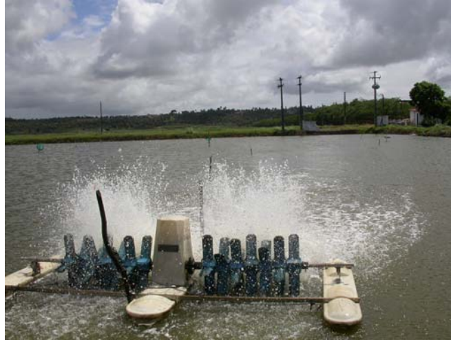
Figura 6: Aerador do tipo canaletas rotativas em funcionamento.
