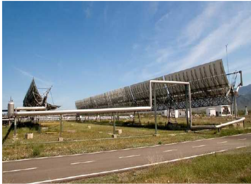
Figura 4. Campo Eurotrough em Almería – Espanha.
