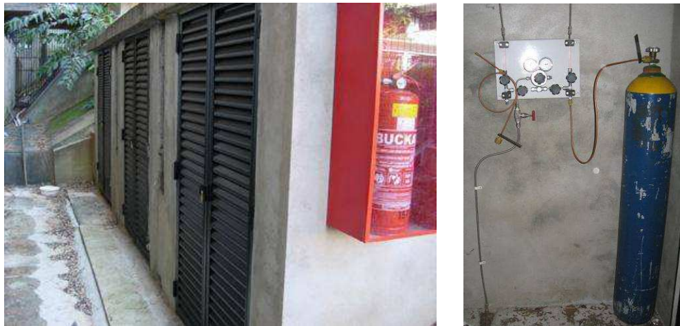
Fig. 7.2 Acomodações dos cilindros de gases
