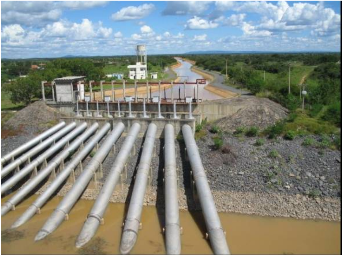
Figura 4 – Estação de bombeamento 1 do Projeto Jaíba, 2006.
