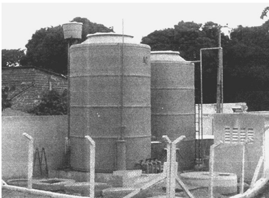
Figura 5.1 – Estação de tratamento do Hospital Waldemar de Alcântara.
