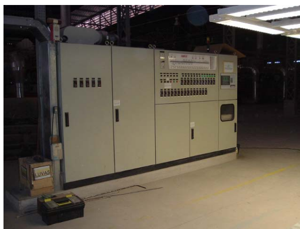
Figura 5.2 – Painel de controle do forno a rolos.
