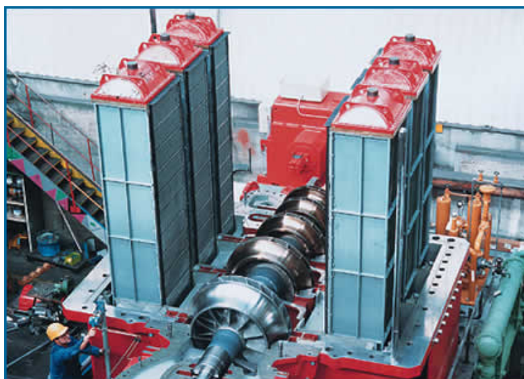
Figura 2.13 - Compressor equipado com resfriadores externos ( intercoolers ). Fonte: MAN, 2007.
