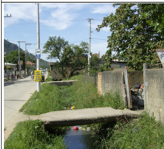
Figura 20: Pontilhões que dão acesso às moradias e casas comerciais sobre o Rio Ribeirão do Porto. Nota-se a presença de lixo e construções sobre o canal. Foto Márcia Cesa. 03/11/2007.
