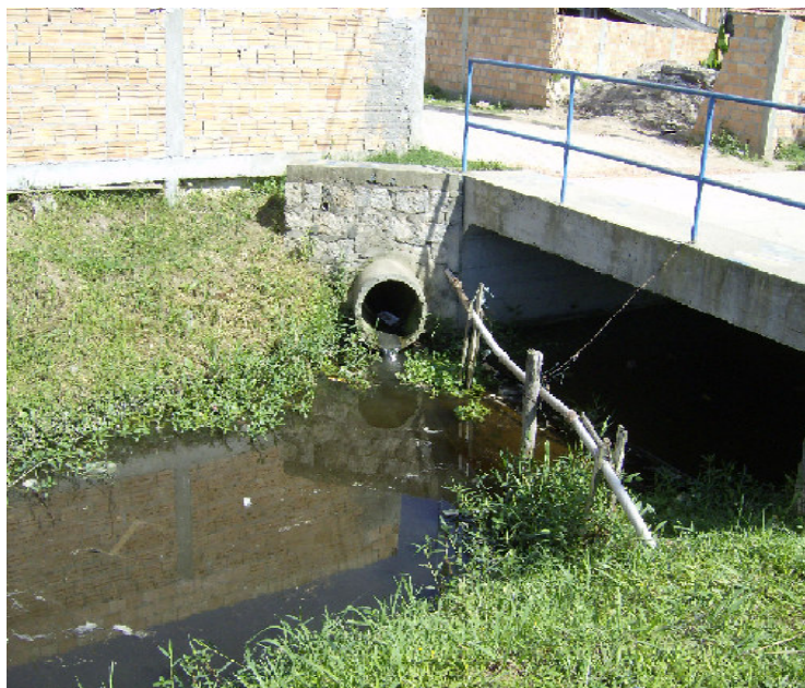
FIGURA 29 – Vista parcial do Rio Ribeirão do Porto (vala da rua do Juca), vê-se um dos vários pontilhões que existem sobre o canal, bem como os muros sobre a margem e o cano pluvial trazendo esgoto e resíduos sólidos para o canal. Este ponto está entre o P1 e o P2.
