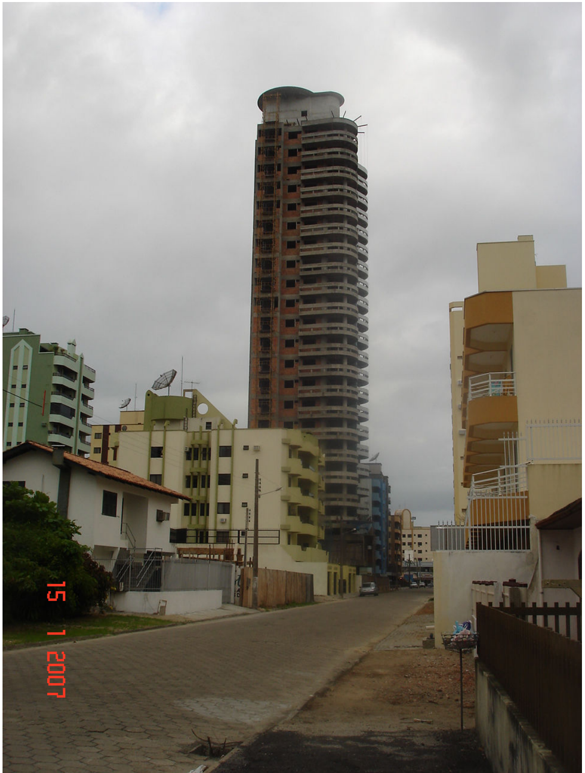
Figura 19 – Edifício de 25 andares, desobediente ao Plano Diretor Municipal Fonte: acervo da autora – janeiro de 2007
