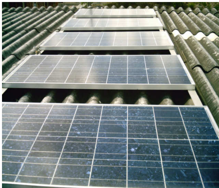
FIGURA 16 - Fotos de painéis fotovoltaicos. FONTE: Pesquisa de dados
