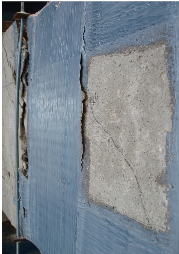
Figura B.37 – Detalhe do descolamento da CFC.
