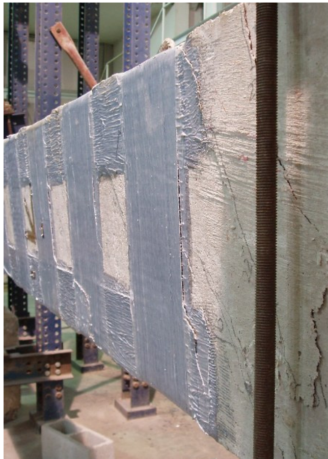
Figura B.44 – Detalhe do descolamento do CFC da viga VTL2 vista da esquerda.
