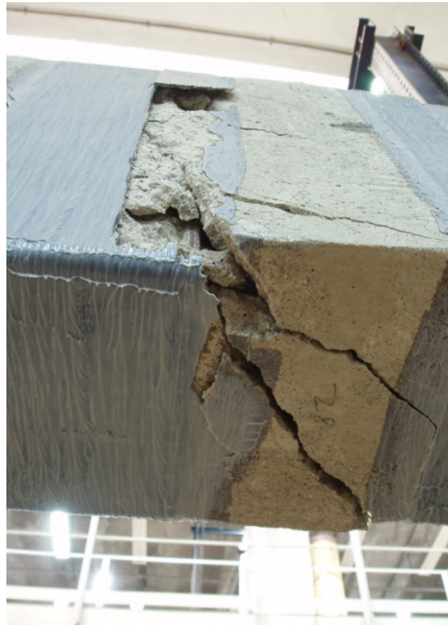
Figura B.30 – Detalhe da ruptura da viga VT3 vista inferior.
