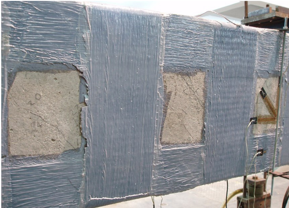
Figura B.43 – Detalhe do descolamento do CFC da viga VTL2 vista da direita.
