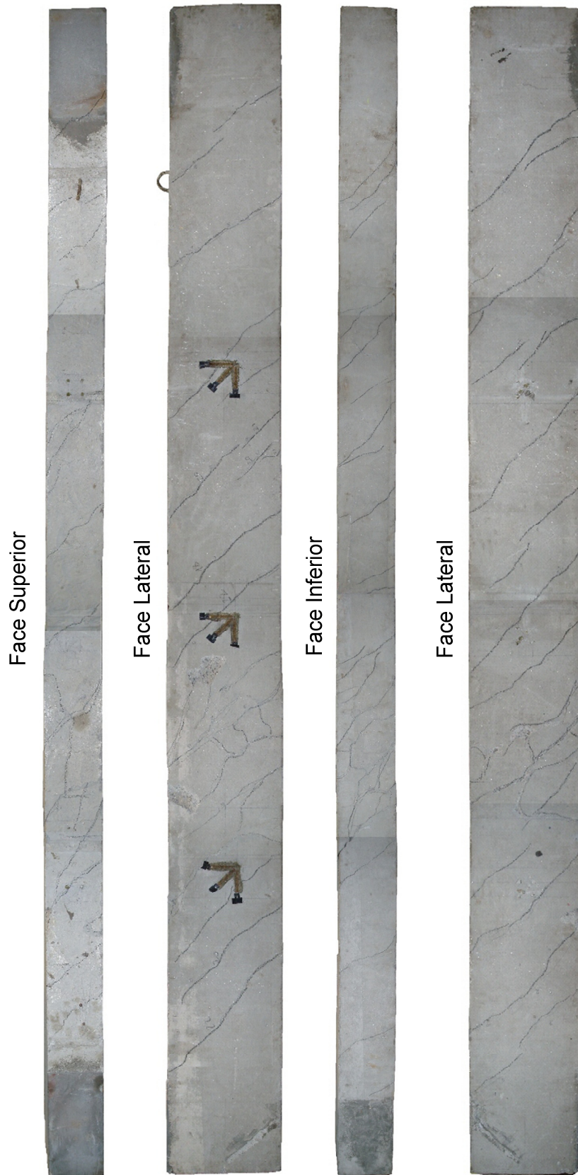
Figura B.10 – Configuração das fissuras da viga VRef.
