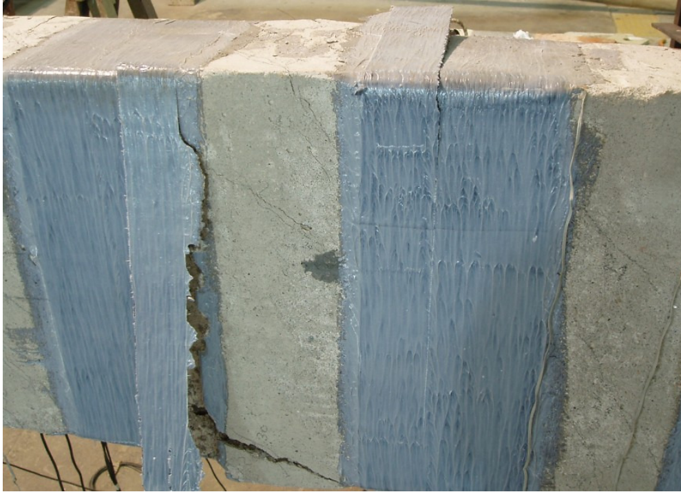
Figura B.29 – Detalhe da ruptura da viga VT3 vista da direita.
