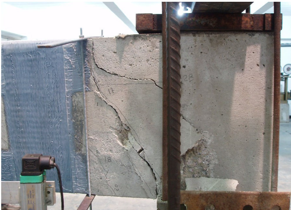
Figura B.35 – Detalhe da ruptura da viga VTL1 vista da direita.
