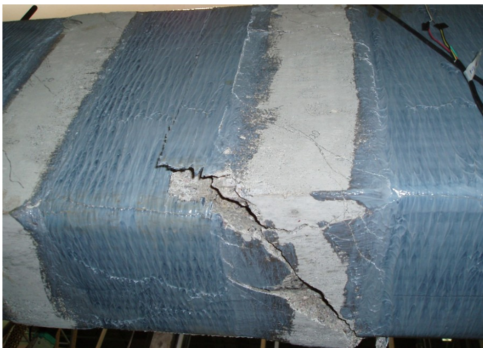
Figura B.16 – Detalhe da ruptura da viga VT1 vista da face inferior.
