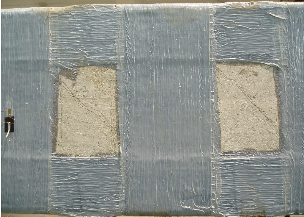
Figura B.50 – Detalhe das fissuras da viga VTL3 vista da direita.
