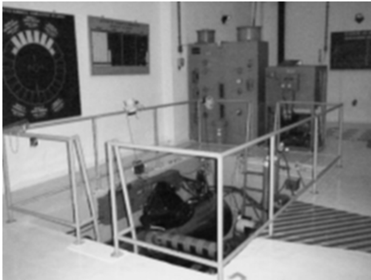
Figura 2.11 - Sistema hidráulico, localizado ao lado do Reator Argonauta.
