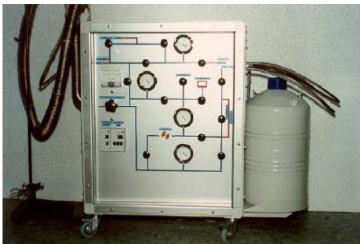
Figura 4.11. Painel de controle do sistema de bombeamento.
