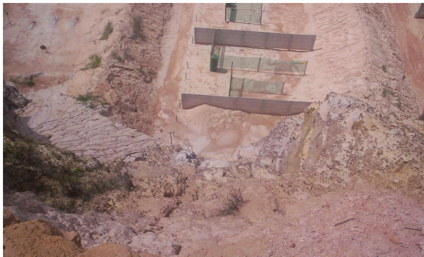
Figura 20 - Encosta apresentando intenso processo erosivo
