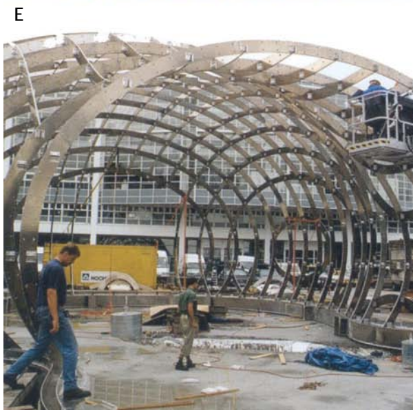
► "Bubble"- Pavilhão de exposição da BMW no IAA 99 - Auto Show, Bernhard Franken e ABB Arquitetos, Frankfurt, Alemanha. A) Modelo digital 3D da estrutura. B) A estrutura em alumínio sendo fabricada em tecnologia CNC com corte de jato de água de alta pressão. C) Moldes de espuma fabricados com tecnologia CAD/CAM para os painéis de vidro e acrílico. D e E) Imagens da estrutura de alumínio com fechamento de vidro e acrílico. [KOLAVERIC, 2003, p. 134]
