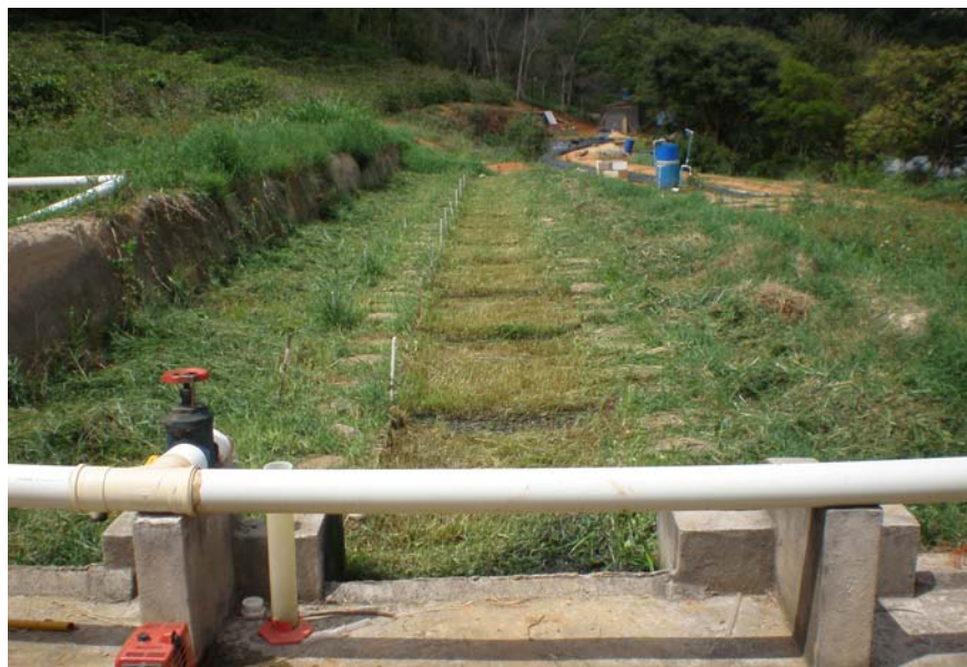
Figura 3 – Canaletas de coleta de material e regularização da distribuição do esgoto ao longo das faixas.
