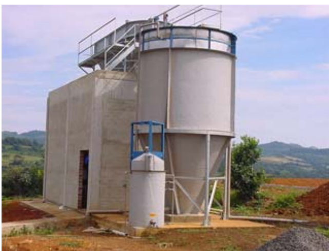
Figura 9 – Reator anaeróbico de manta de lodo
