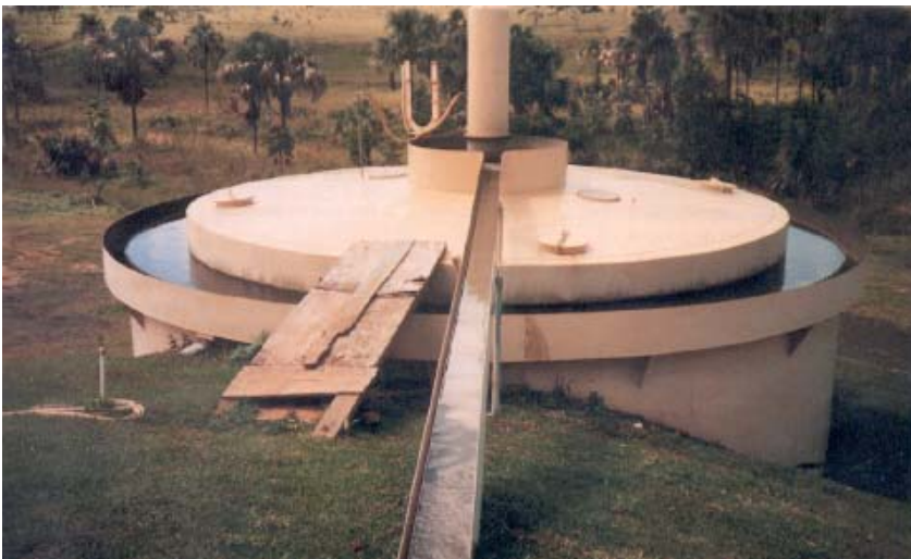
Figura 13 – Tanque anaeróbio ou sistema Imhoff
