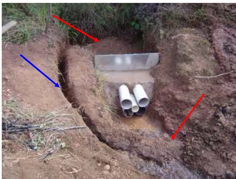
Fig. 5 – Esta figura ilustra o vertedouro de medição de vazão em sua fase final de construção. A seta azul indica onde era o canal de desvio e as vermelhas indicam o posicionamento das ensecadeiras durante a construção.
