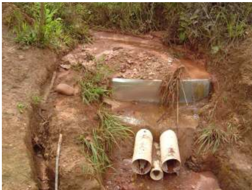
Fig. 48b – Vertedouro após a primeira chuva do período chuvoso de 2004/2005 (ALVES – Outubro de 2004).
