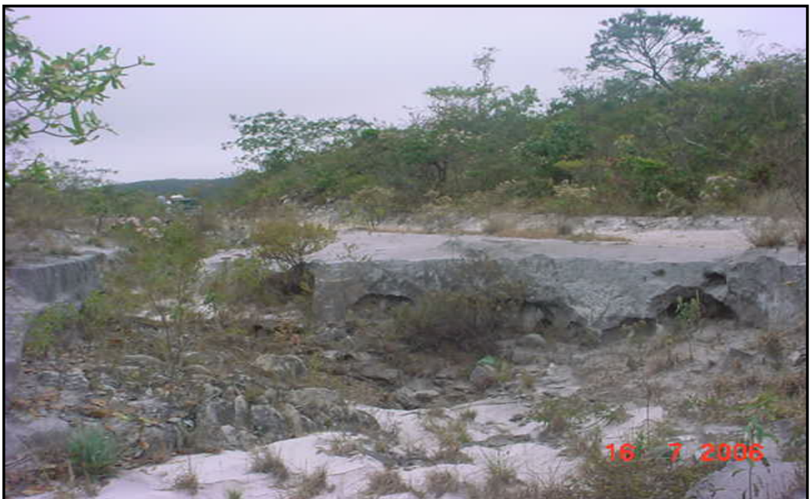
Figura 30 – Estrada foi desviada devido ao acelerado processo erosivo Autora: OLIVEIRA, R.I.C. Jul/2006
