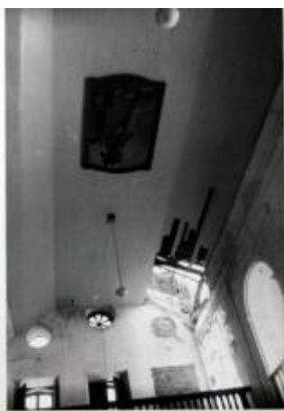
Figura 6. Forro de madeira parcialmente destruído pela desestabilização da torre da Igreja dos Martírios Fonte: IPHAN/ 5° SR
