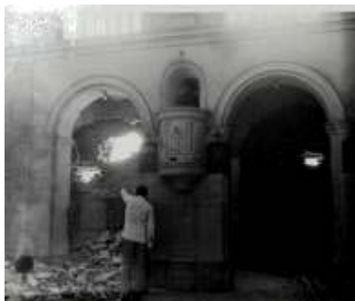
Figura 7. Entulhos no interior da igreja Fonte: IPHAN/ 5° SR
