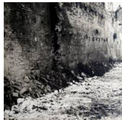
Figura 12. Parede da igreja completamente solta Fonte: IPHAN/ 5º SR
