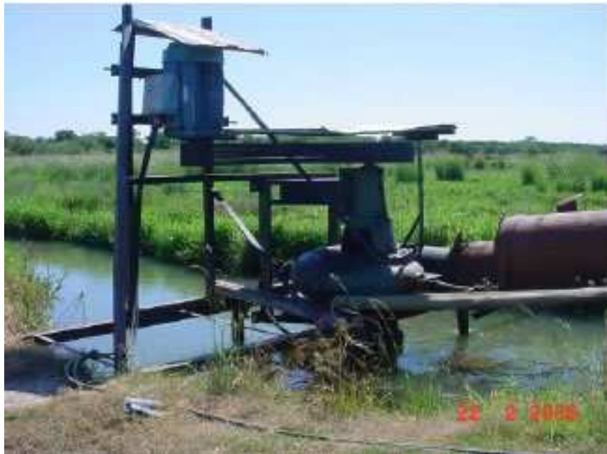
Figura 5.9. Instalação Obsoleta e Apresentando Baixa Eficiência Operacional. Fonte: Relatórios Energéticos Produzidos pelo GEE.
