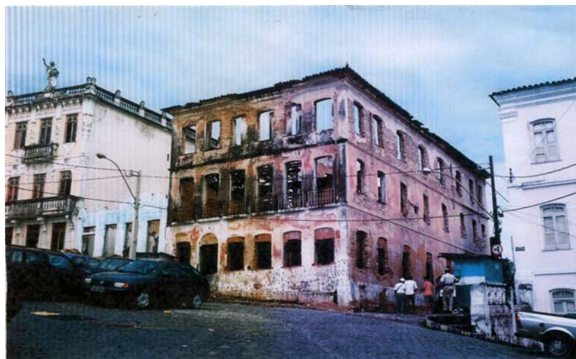
Figura 43: Ruína no Largo da Palma, onde viria a se instalar o hotel A Casa das Portas Velhas, 2002
