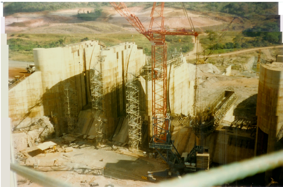
FIGURA 09 – Obra da Usina Hidrelétrica de Miranda. FONTE: BORGES, Adairlei A. da Silva. 1996.
