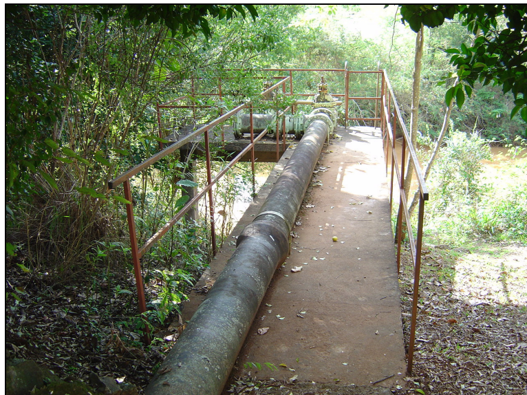
Figura 14: Aspecto do local de captação de água no rio Jacutinga, na Comunidade Jacutinga. Vê-se parte da tubulação captando água do Rio Jacutinga, e conduzindo-a até a ETA, localizada na cidade de Coronel Vivida/PR. (Foto da autora 23/04/2005).
