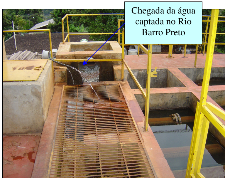
Figura 38: Vê-se a chegada da água e os tanques onde se efetua o tratamento da água captada no Rio Barro Preto – ETA de Coronel Vivida. No lado direito observam-se alguns dos tanques onde são realizadas a floculação e filtração da água. A chegada desta água aos tanques, é visualizada na parte superior esquerda da foto. (Foto da autora 15/05/2005).
