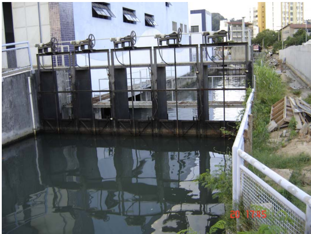
Figura 56. Comportas para retenção do fluxo da maré [em situação fechada], localizada na galeria do Bairro Bento Ferreira, à Rua Jair Etienne Dessaune. Registro fotográfico obtido às 17h 45min, do dia 20/02/2007, 25 min após a preamar.
