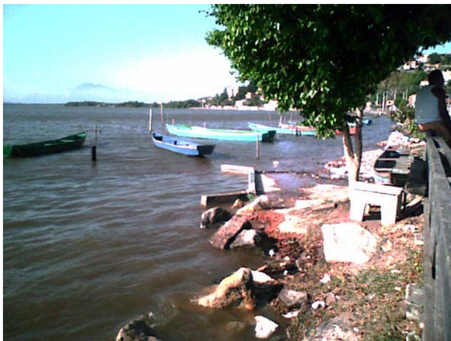
Figura 51. Saturação pela maré, observada na galeria de drenagem do Bairro Bela Vista, no dia 19/03/2007, único bairro da zona Oeste de Vitória, dentre os analisados, que não apresentou alagamento de vias públicas e moradias neste dia, em que a maré atingiu, na Baía do Espírito Santo, o valor máximo de 1,75 m, às 15h 30min local.
