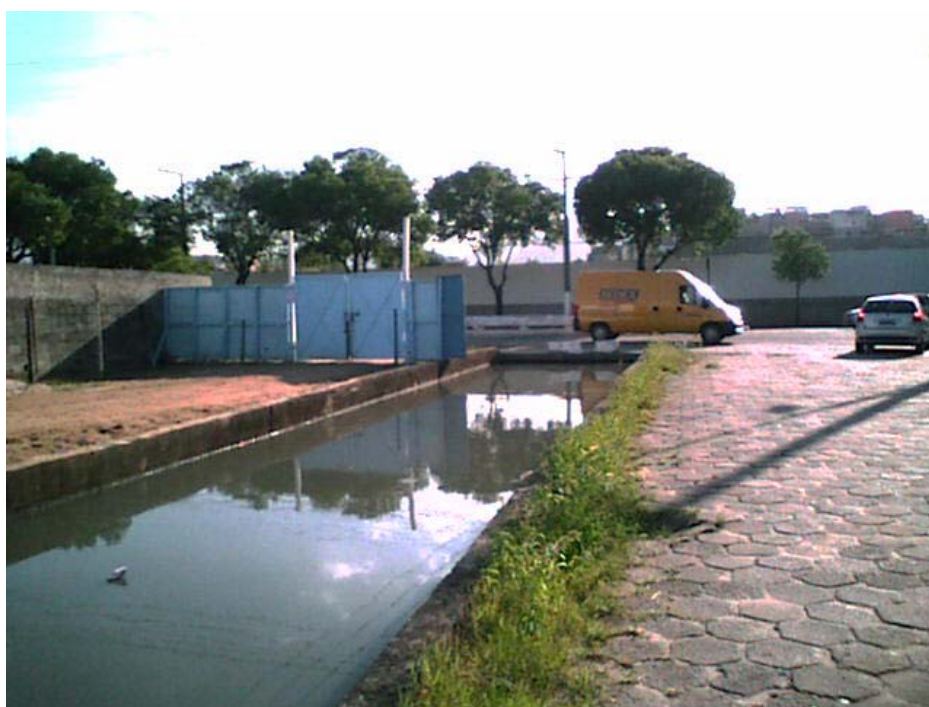
Figura 55. Saturação pela maré, observada na galeria de drenagem do Bairro Barro Vermelho, no dia 19/03/2007, na zona Norte de Vitória. Registro de parte do trajeto da galeria, situado na Rua José Farias, naquele momento em obras.
