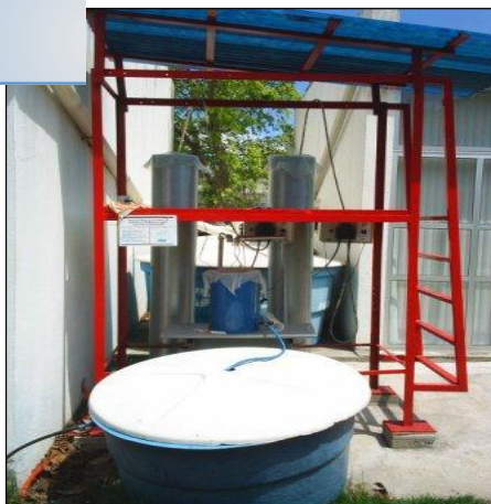
Figura 4.11 - Vista Geral do Sistema
