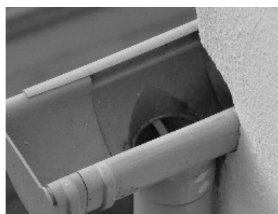
Figura 27 – Calha em PVC
