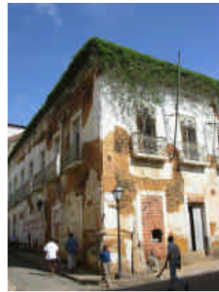
Figura 39: Sobrado sem uso e em ruínas. Fonte: Autora, 2003.
