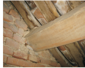
Ataque de térmitas e umidades no madeiramento da cobertura
