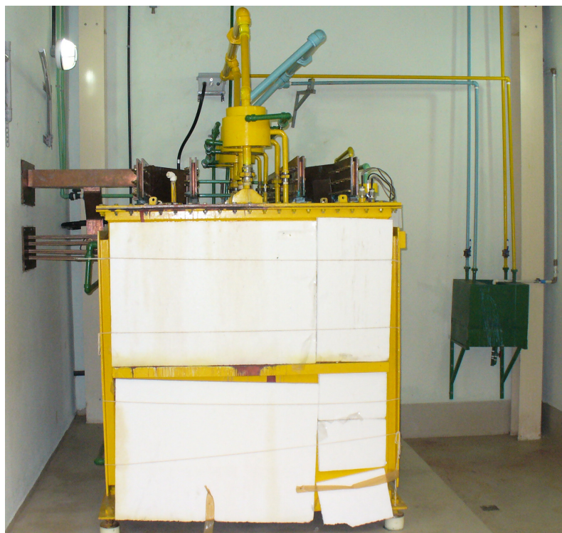
Figura 6.1 - Visão geral do eletrolisador do laboratório da CEMIG.
