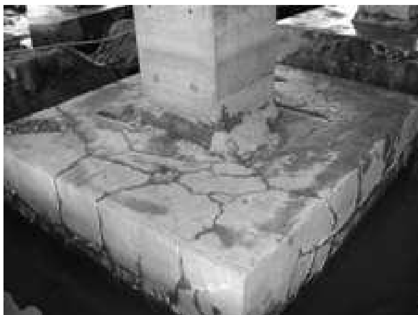
Figura 1: edifício residencial em Recife, de 10 anos de idade, apresentando reação álcali-agregado nos blocos de fundação (ANDRADE, 2007).
