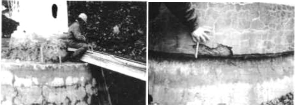
Figura 4: estrutura de fundação atingida por RAA, no Canadá (DURAND, 2000).
