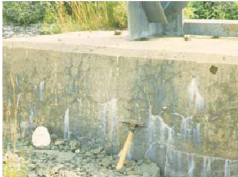
Figura 5: estrutura de fundação atingida por RAA, no Canadá (FOURNIER et al., 2005).
