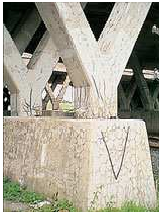
Figura 7: reação álcali-agregado em estrutura de fundação no Canadá (PORTLAND CEMENT ASSOCIATION, 2007).
